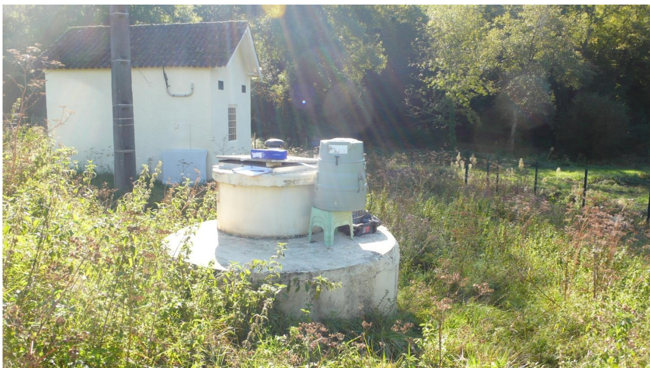
Figure 49 : Préleveur automatique sur la source du Coderc
