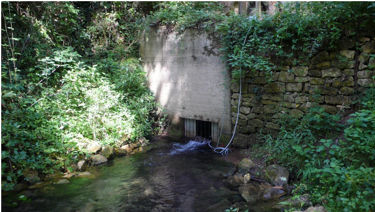
Figure 12 : Vue du captage après aménagement du seuil jaugeur (prise de vue : 27/09/2017)
