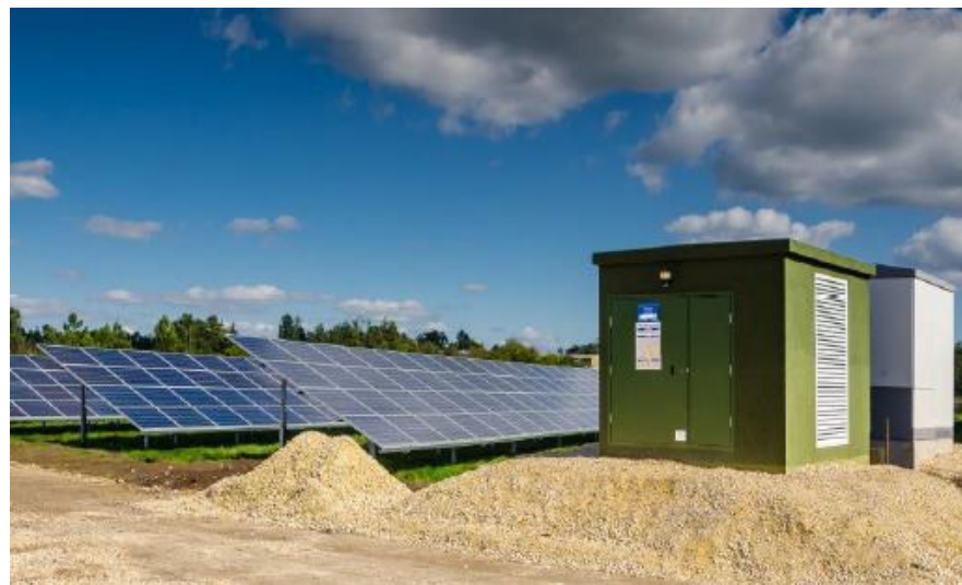
Photo 25 : Poste de transformation HTA/BT
