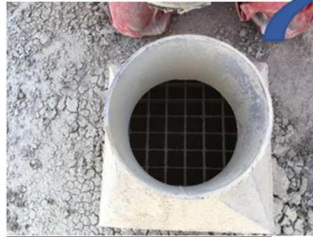
Silo- Grille avec maille de 2 cm mise en place à la fin du process pour retenir d'éventuels corps étrangers.
