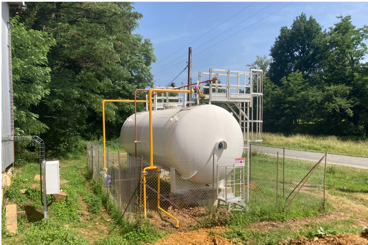
Figure 17 : Cuve de gaz
