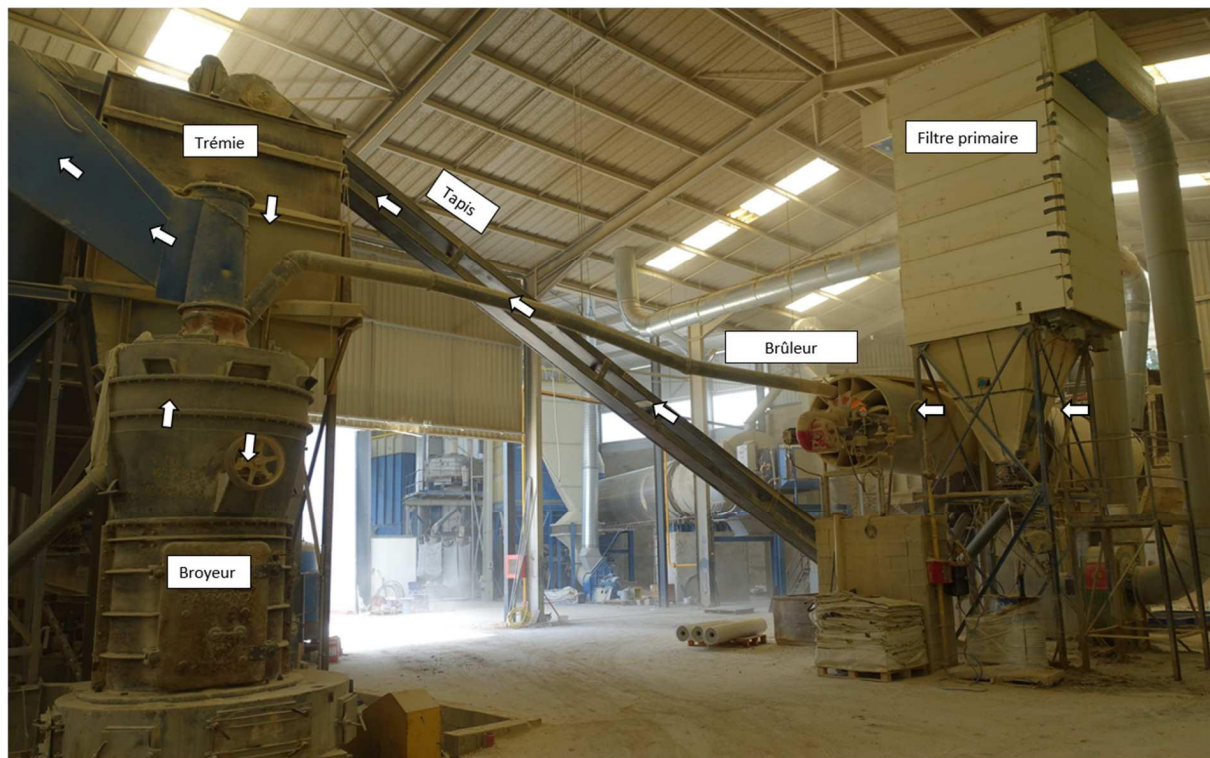
Figure 8 : Brûleur, sécheur et filtre de la ligne de production initiale
