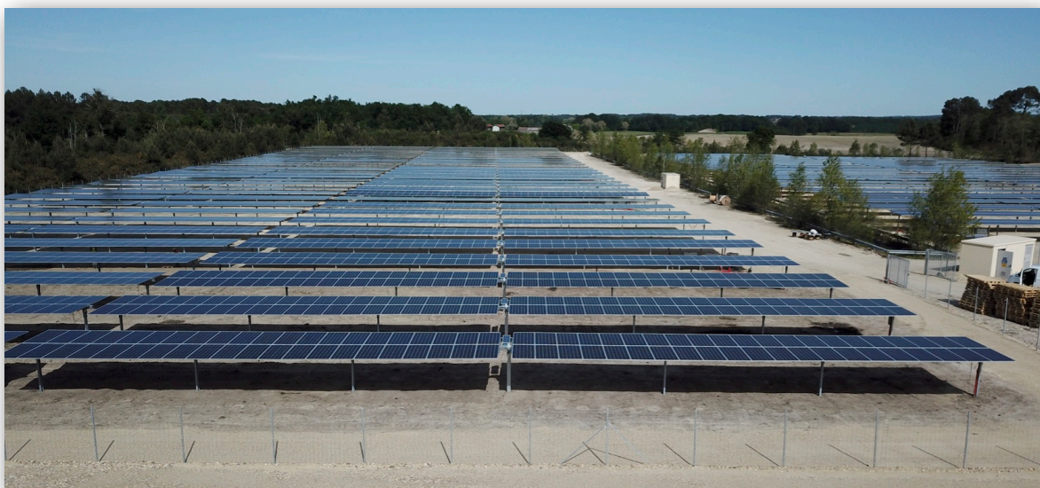
Exemple d'implantation de trackers (centrale de Brannens - 33)
