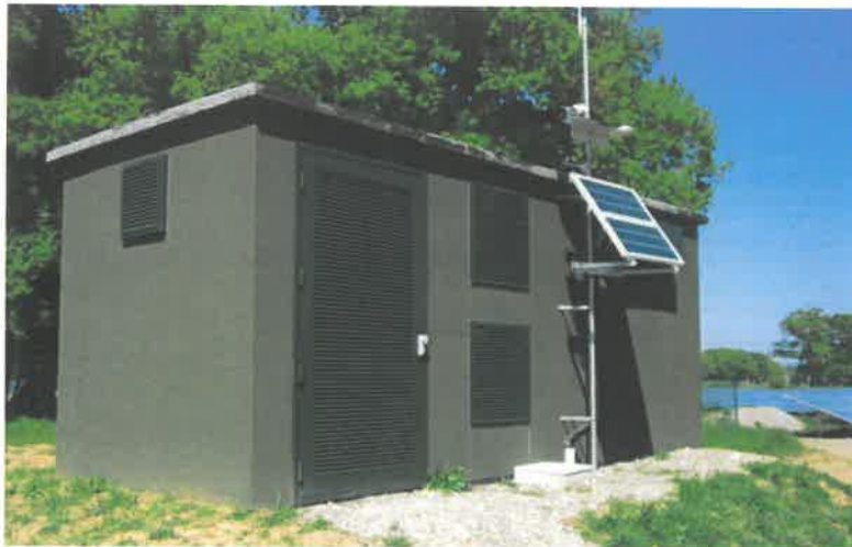
Exemple de poste de livraison
