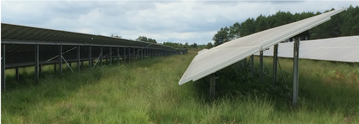
Figure 22 : Développement de la végétation sous les panneaux (source Realys Environnement ©)
