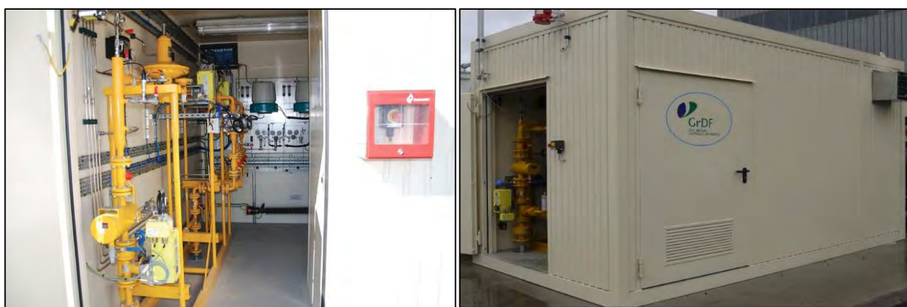
Figure 14 : Poste d'injection de biométhane dans le réseau GrDF
