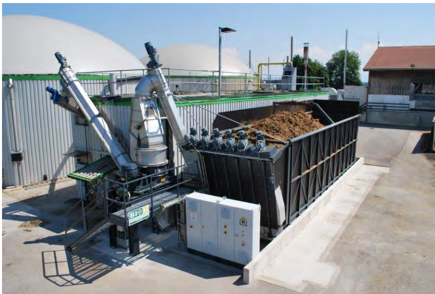
Figure 7 : Trémie d'incorporation (BIOG)
