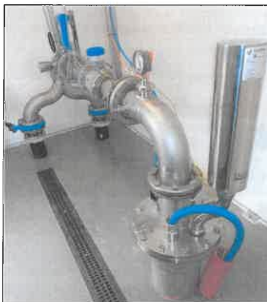
Tête de puits du forage F5
