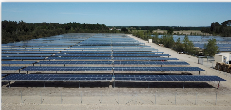
Exemple d'implantation de trackers (centrale de Brannens - 33)
