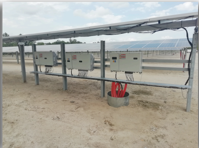
Raccordements électriques des tables
