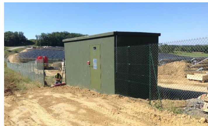
Exemple de poste de livraison couleur RAL 6011 sur un parc solaire
