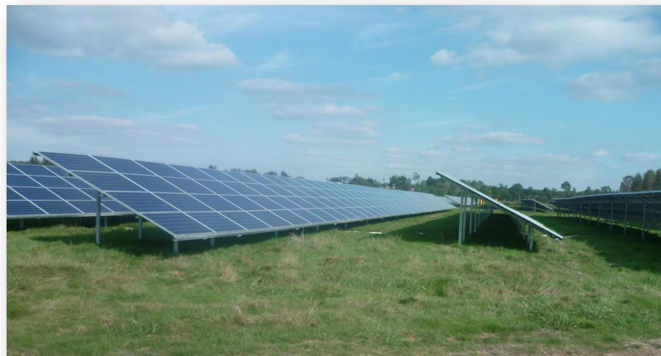
Parc solaire de Saint-Aubin-de-Blaye (33)
