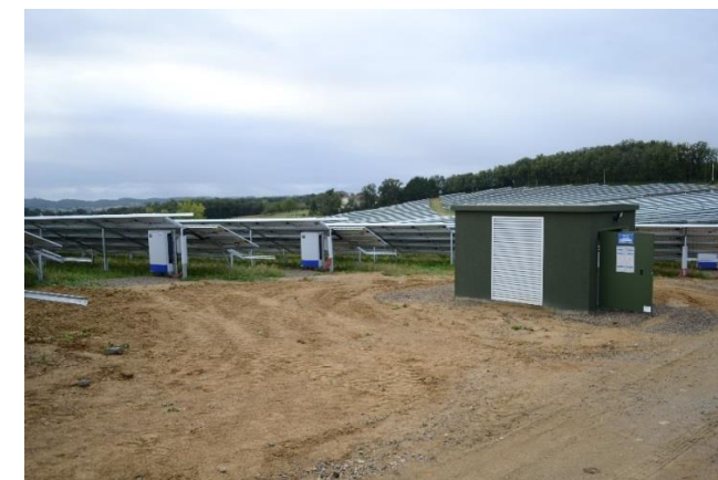
Exemple de poste de transformation couleur RAL 6011 sur un parc solaire
