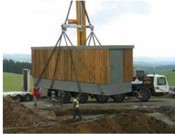
Figure 3 : Illustration de livraison d'un poste de transformation électrique sur un parc éolien (source : VALECO, 2021)
